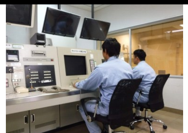
制御室で装置の運転・監視中！
